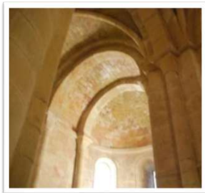
Imatge 11. Restes de pintura a la coberta de les capelles radials
