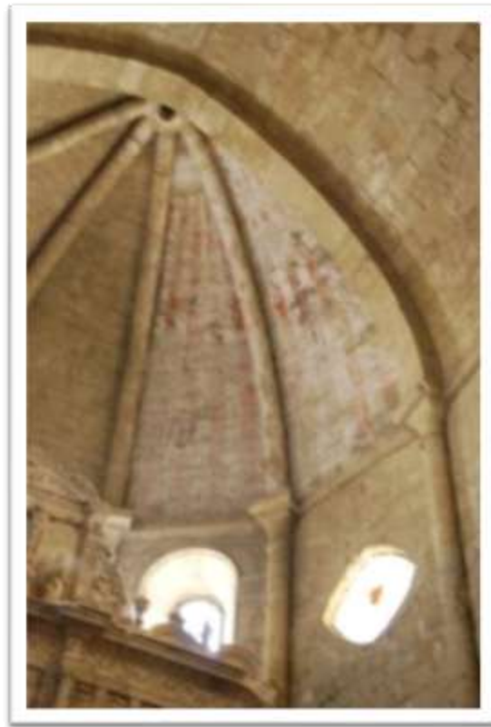
Imatge 10. Restes de pintura a la coberta de l'absis
